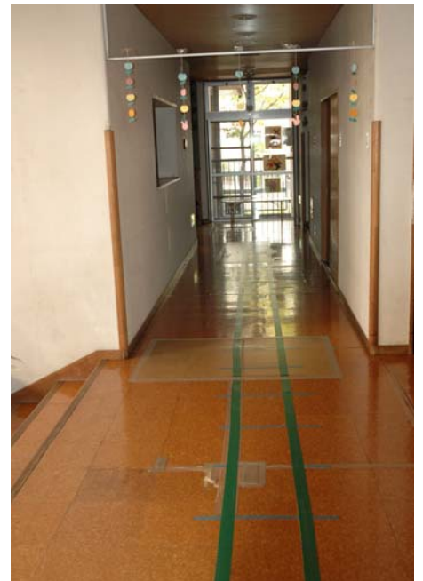
写真-5 乳児保育所の床暖房で傷んだコルクタイル
